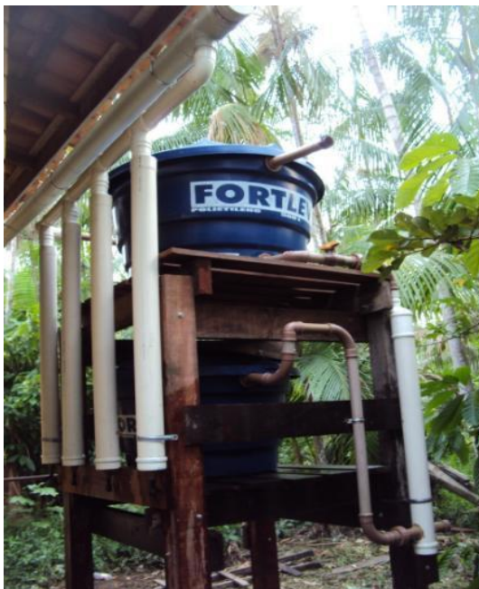
Figura 73 - Sistema de abastecimento com uso da água de chuva instalado pelo GPAC Amazônia/UFPA na ilha Grande.
