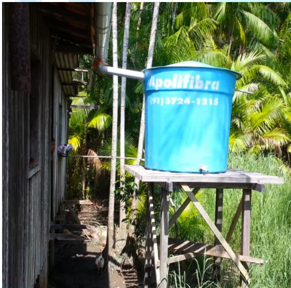
Figura 75 - Sistema de abastecimento com uso da água de chuva instalado pela Cáritas/Belém na ilha
