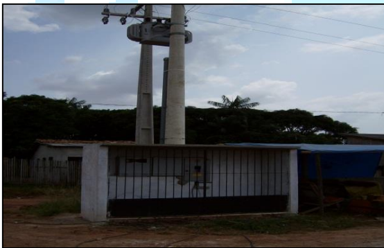
Figura 36 - Subestação e poço.
