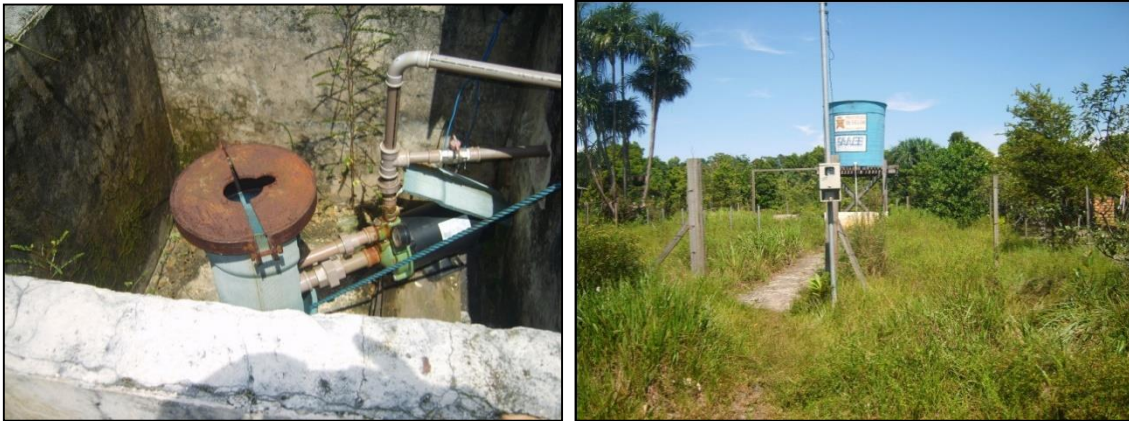
Figura 49 - Captação e elevatória da Unidade Água Poção.
