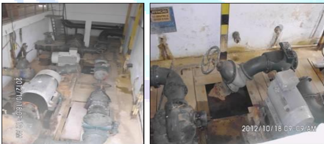
Figura 21 – Conjuntos motobomba – operantes e reserva
