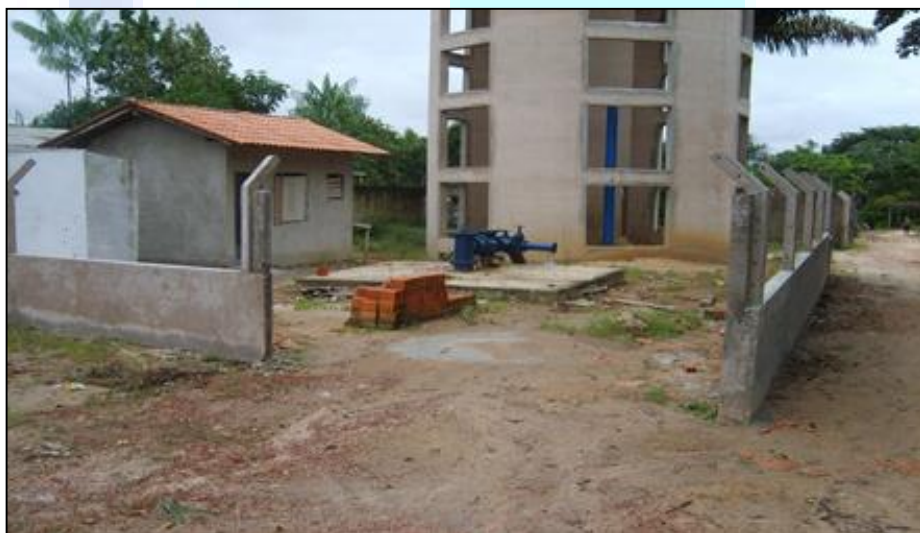
Figura 54 - Poço e reservatório Carananduba.
