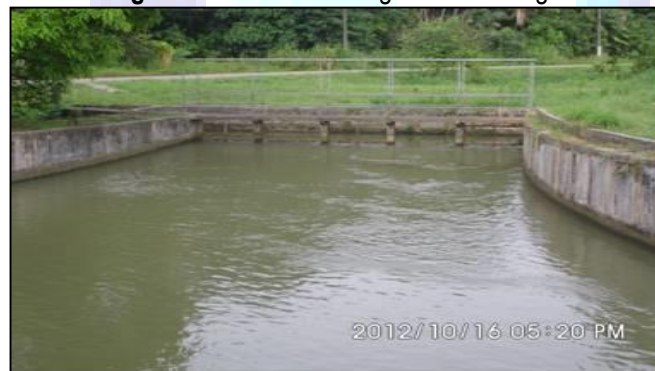
Figura 23 - Canal de chegada ETA Utinga.
