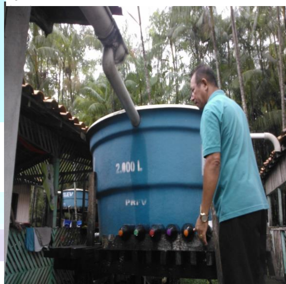
Figura 76 - Sistema de abastecimento com uso da água de chuva, instalado pela Cáritas/Belém na ilha
