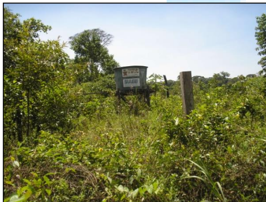
Figura 51 - Estação elevatória da Unidade Pedra Branca.
