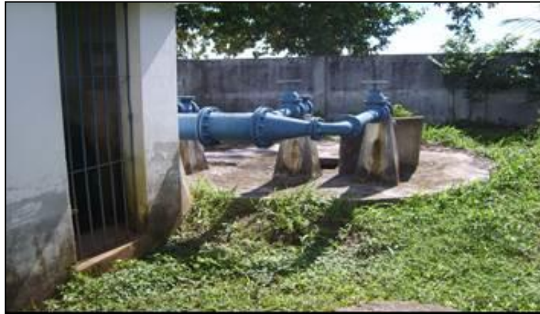
Figura 71 - Cisterna e estação elevatória da Unidade EEE – B5.
