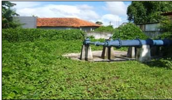
Figura 72 - Estação elevatória da Unidade EEE – B6.
