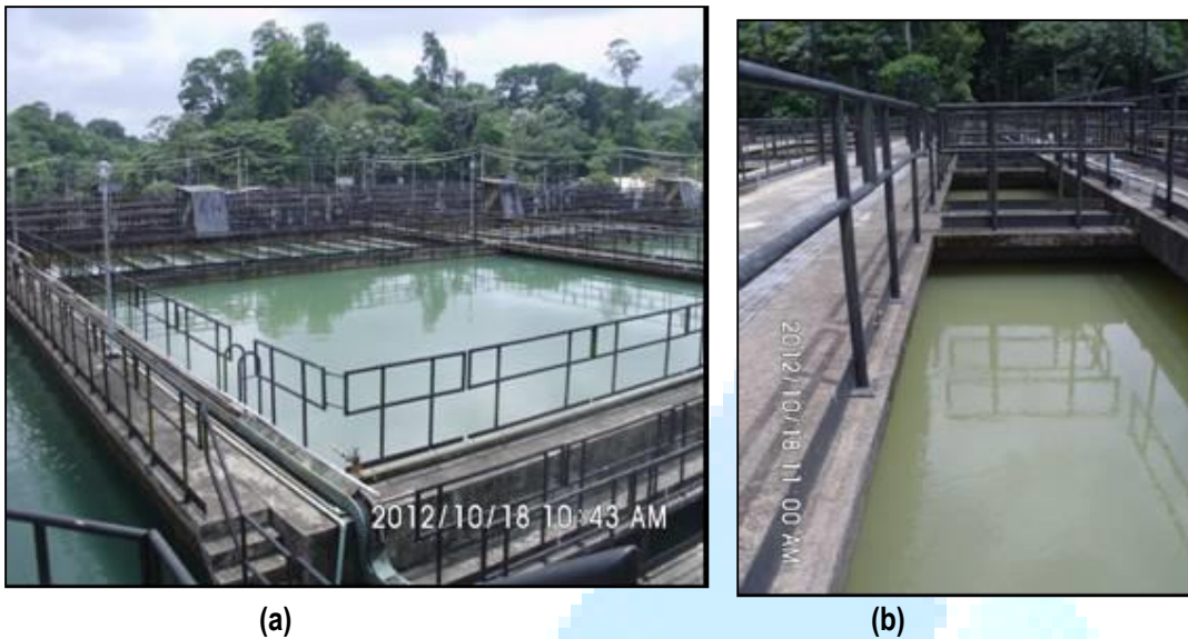
Figura 17 - Caixa de Chegada – ETA Bolonha (a); Decantadores - ETA Bolonha (b).
