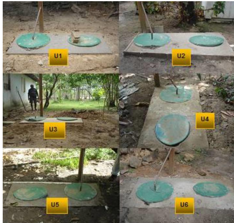
Figura 84 – Reatores UASB em comunidades rurais em área de terra firme.
